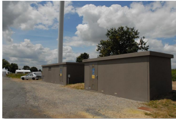
Photo 79 : Exemple de poste de livraison
